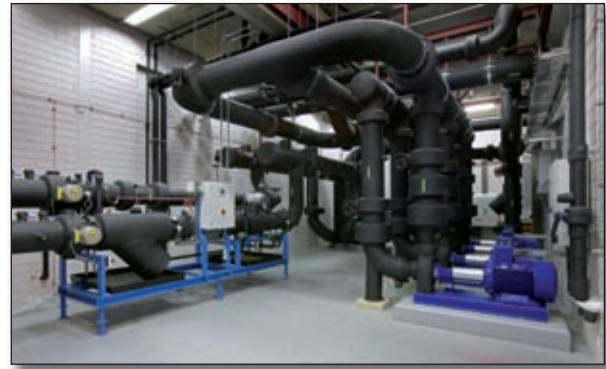
3D-ontwerp is gelijk een virtuele realisatie, het beperkt daardoor fouten en tekortkomingen bij montage.
